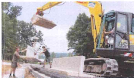
Zwischen Oberbernbach und Motzenhofen baut die Firma Schelle einen Amphibientunnel, um den Kröten das Überqueren während der Laichzeit gefahrlos zu ermöglichen.
